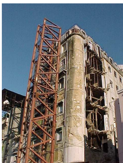
Figura 3.21 – Desabamento de parte da fachada Sul (fonte: Alberta Midões, 2002)
